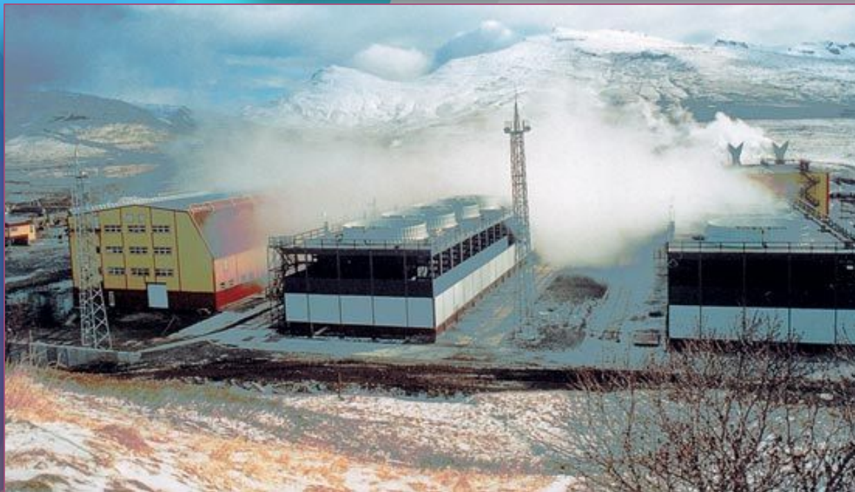
Геотермальная электростанция ГеоЭС
