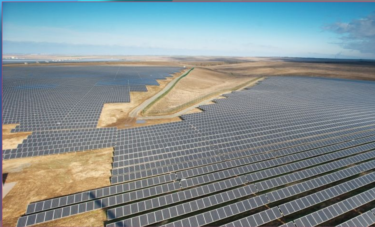
Солнечная электростанция (СЭС)
