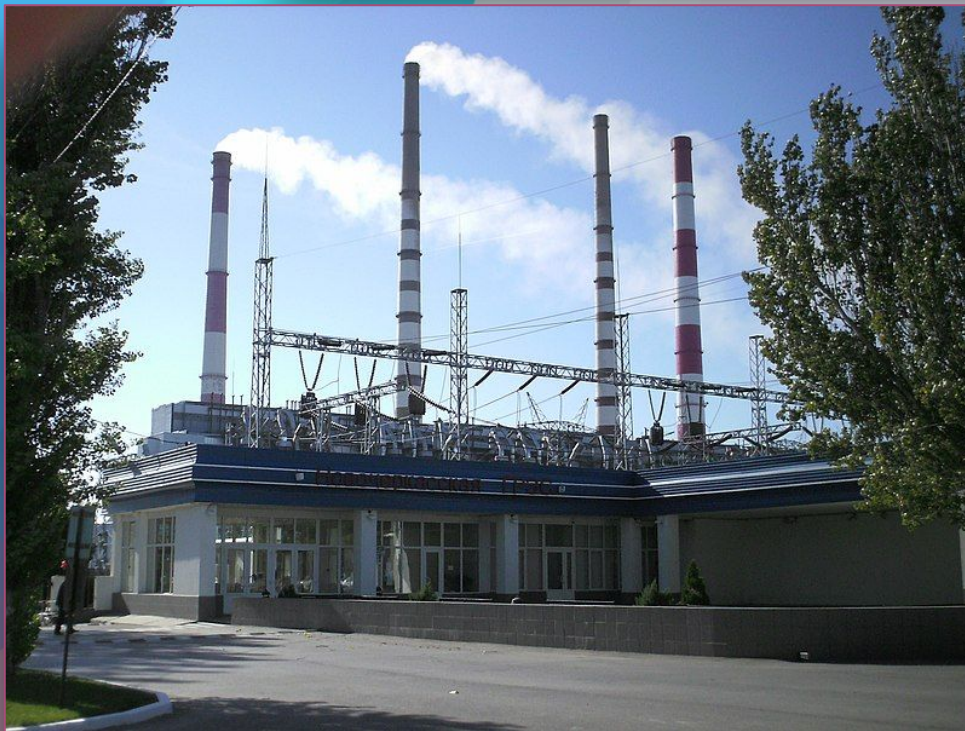
Тепловая электростанция (ТЭС)
